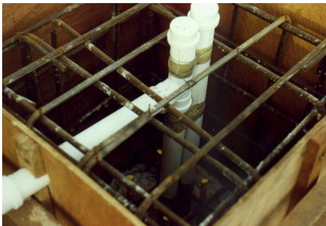
Foto 4.2 – Detalhe do prolongamento do tubo galvanizado.
