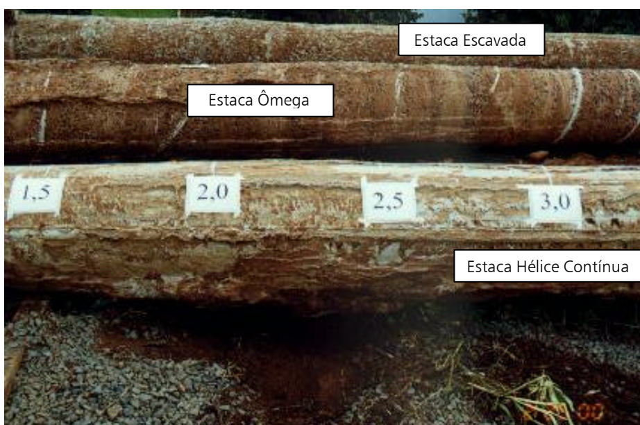
Foto 4.19 - Aumento do diâmetro da estaca hélice contínua 2 no trecho de 1,5 a 3,0m (1º Plano).
